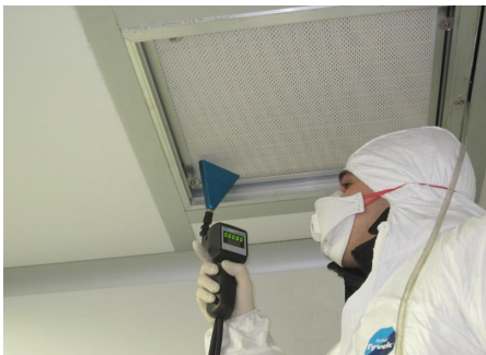
Misura dell'efficienza di un filtro HEPA in campo (CTS)
